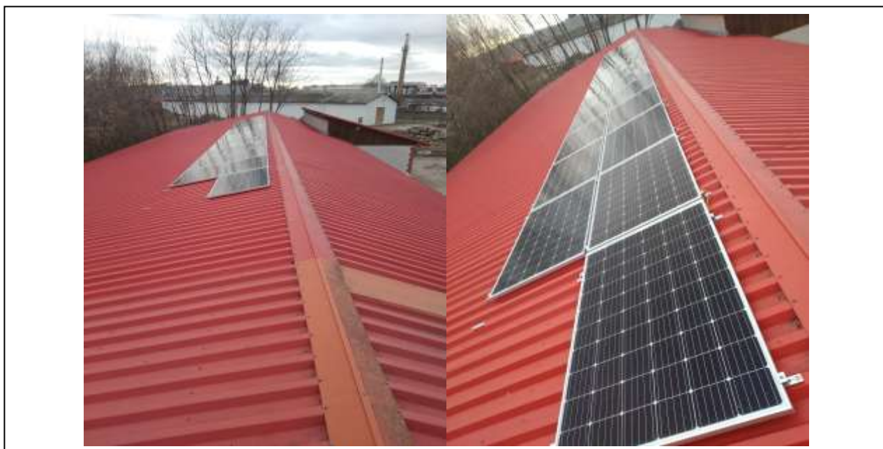
8,235 kW teljesítményű napelemes rendszer
